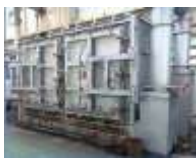
Li-ion電池 リサイクル設備
